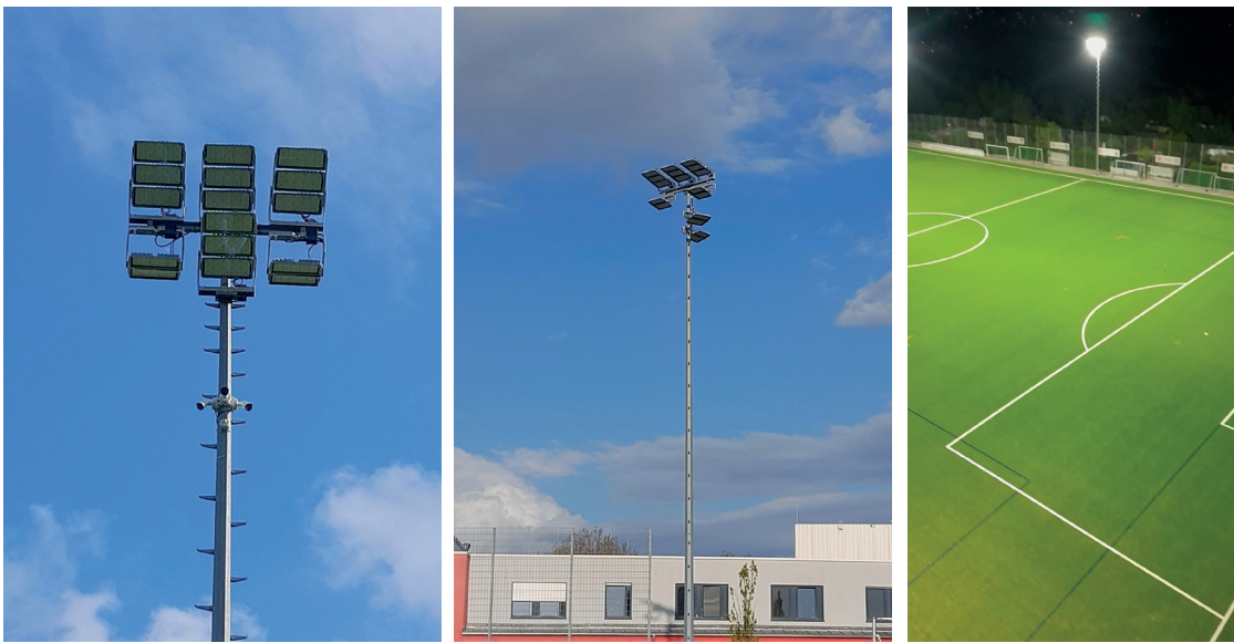
Bilder: Trainingsgelände Eintracht Frankfurt am Riederwald mit Siteco Fluter FL11
